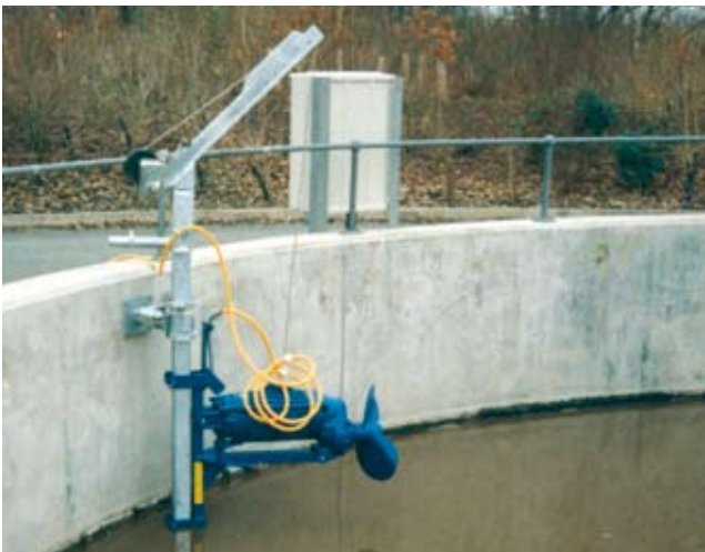
Tauchmotorrührwerk GTWSI 1040 im Schlammstapelbehälter einer Kläranlage
