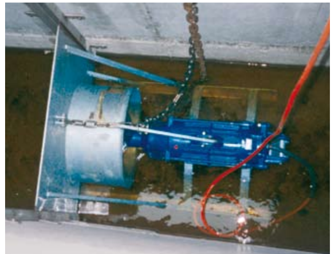
Tauchmotorrührwerk in Ringkanalsystem
